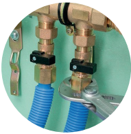
Réseau de plomberie en PER
